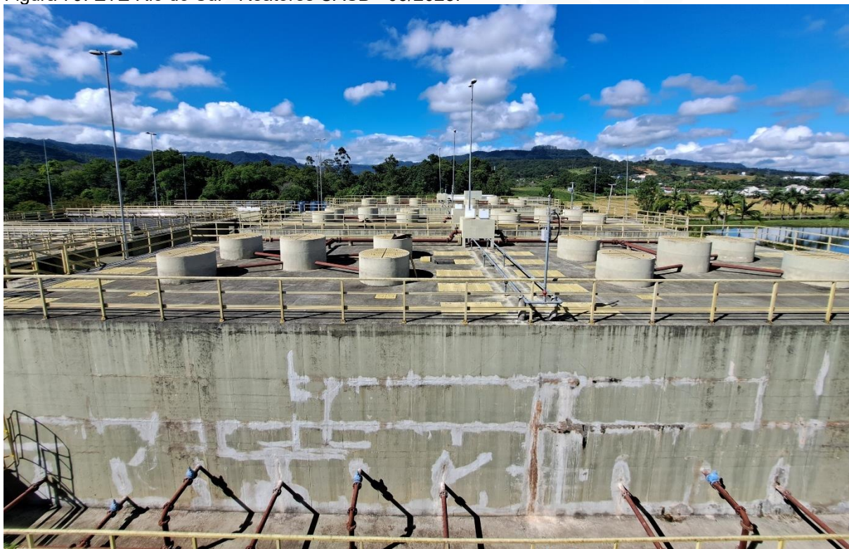
Figura 79: ETE Rio do Sul - Reatores UASB - 03/2025.
