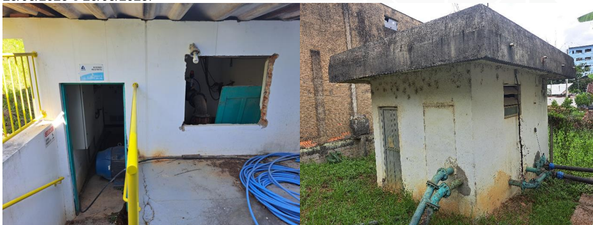
Figura 63: Má conservação das unidades de recalque – ERAT 03 (esquerda) e ERAT 16 (direita) entre 25/03/2025 e 26/03/2025.
