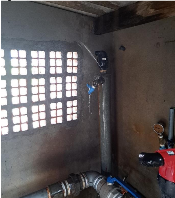
Figura 67: Vazamentos no booster 6 - em 25/03/2025.
