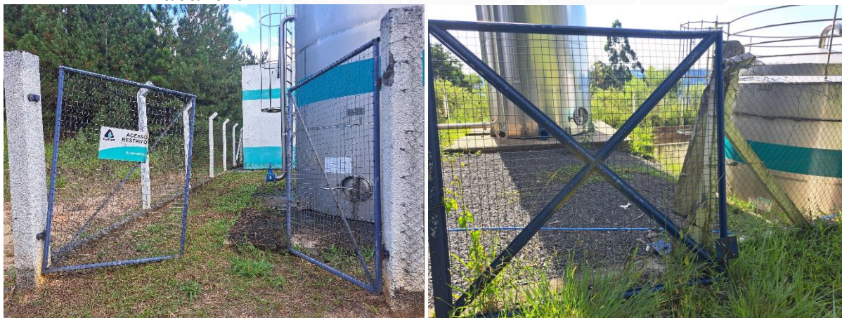
Figura 56: Portões de acesso aos reservatórios Loteamento Cedros (esquerda) e R13 (direita) danificados – em 26/03/2025.
