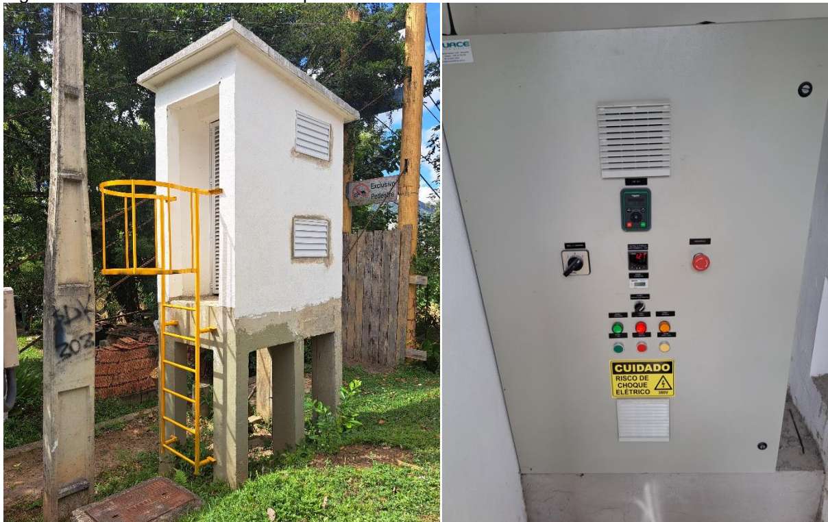
Figura 72: Elevatória EE-E3- 5 CV – painel de comando – 03/2025.
