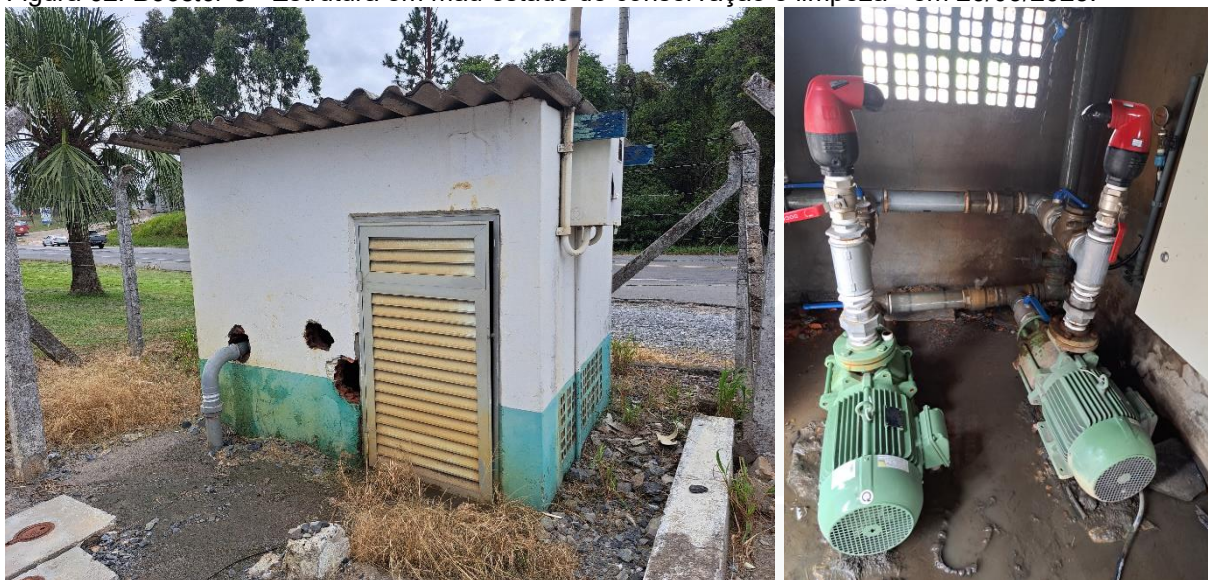
Figura 62: Booster 6 - Estrutura em mau estado de conservação e limpeza - em 26/03/2025.
