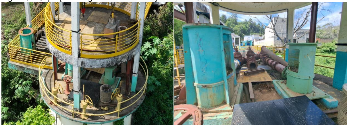
Figura 37: Captação de água bruta no Rio Itajaí do Sul – 03/2025.
