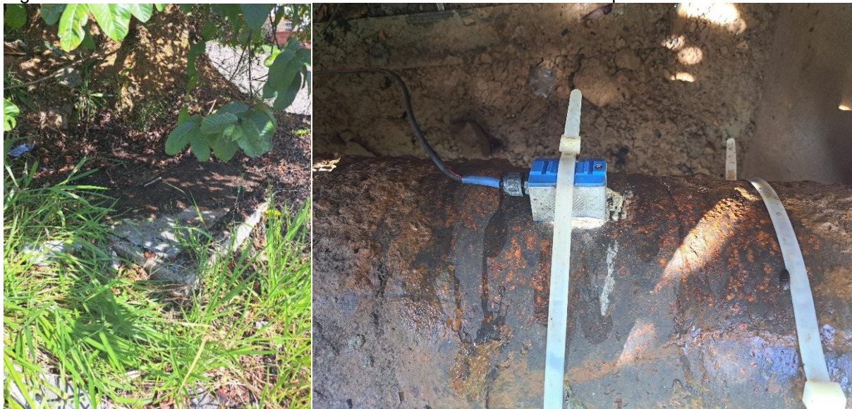
Figura 52: Macromedidor ultrassônico da adutora do R0 instalado na via pública.
