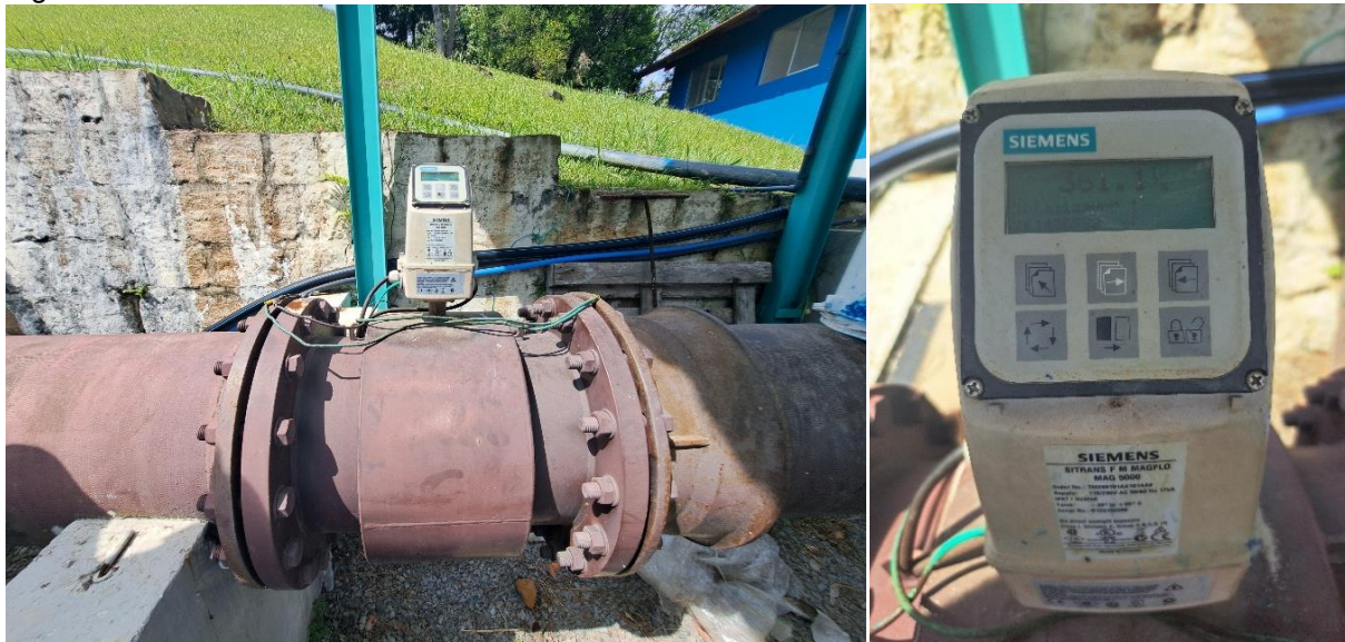
Figura 39: ETA RIO DO SUL - Macromedidor de entrada – 03/2025.
