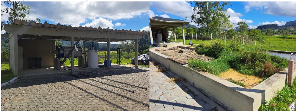
Figura 85: ETE Rio do Sul – Unidade de tratamento do lodo - 03/2025.
