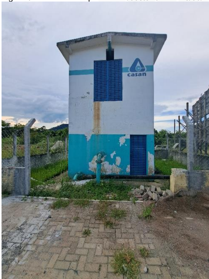
Figura 61: Ausência de portão no booster 5 - em 26/03/2025.
