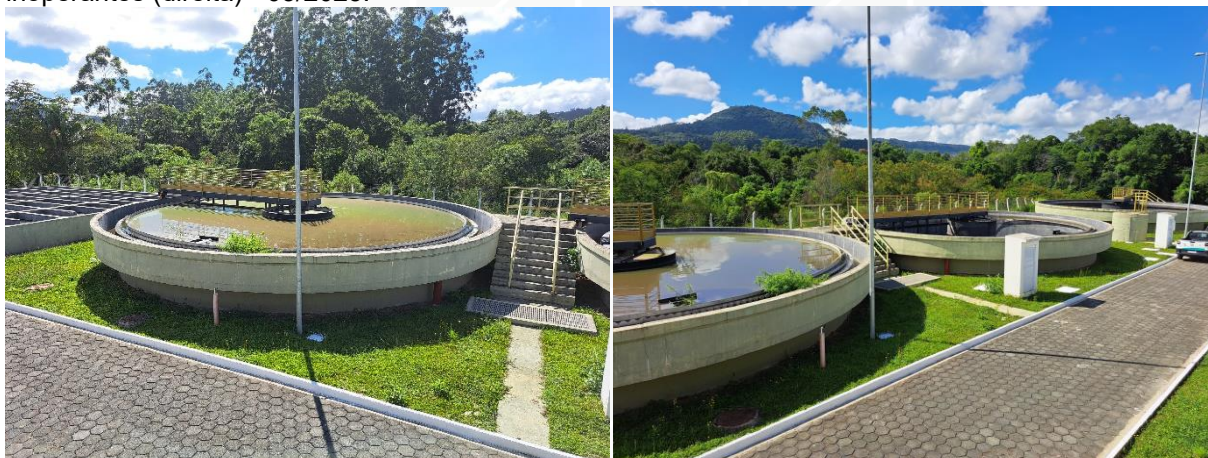
Figura 83: ETE Rio do Sul – decantador secundário em operação (esquerda) e decantadores inoperantes (direita) - 03/2025.
