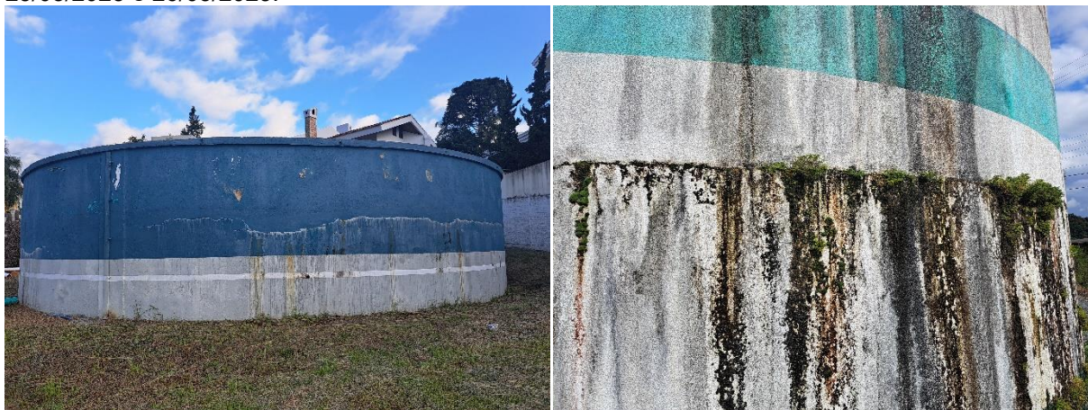
Figura 59: Reservatórios R1 (esquerda) e R12 (direita) em mau estado de conservação – entre 25/03/2025 e 26/03/2025.
