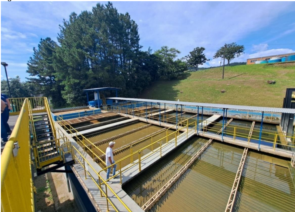
Figura 46: ETA Rio do Sul - decantadores – 03/2025.
