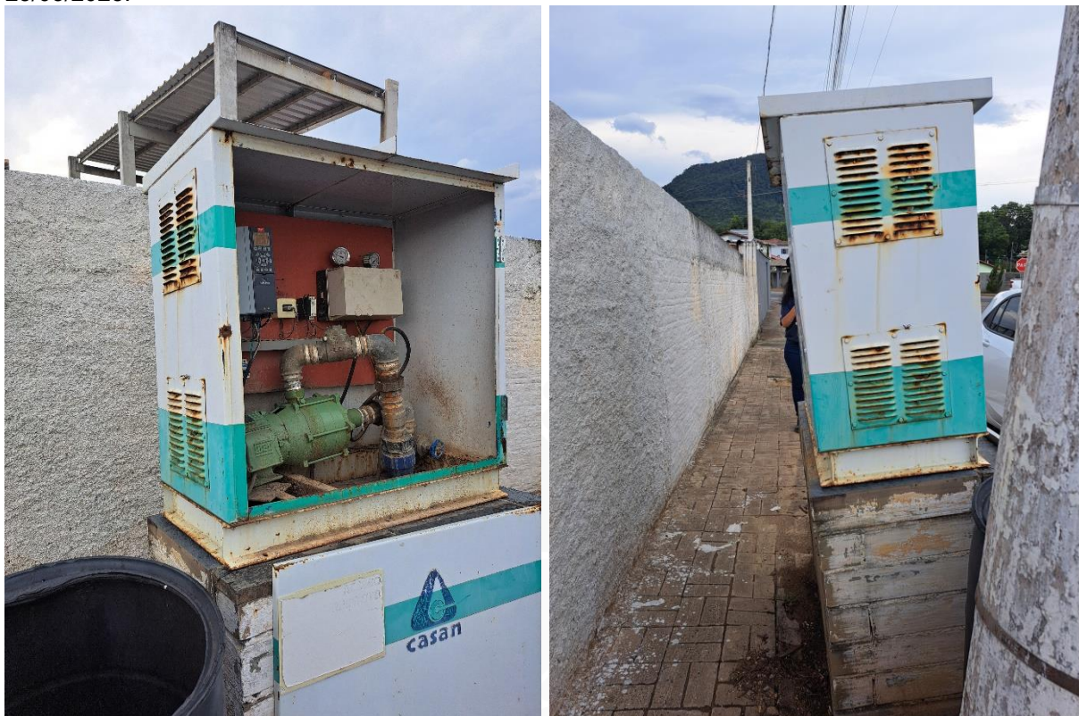
Figura 64: Booster 56 - Abrigo metálico danificado e base inclinada devido a recalque do solo - em 25/03/2025.
