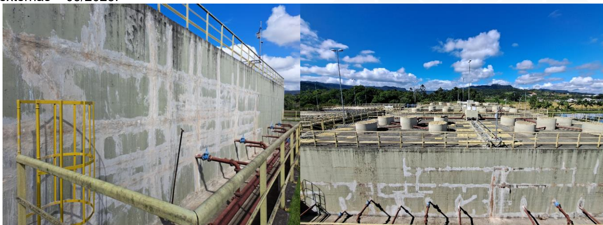
Figura 86: Estrutura dos reatores UASB, com presença de diversos reparos superficiais nas paredes externas – 03/2025.
