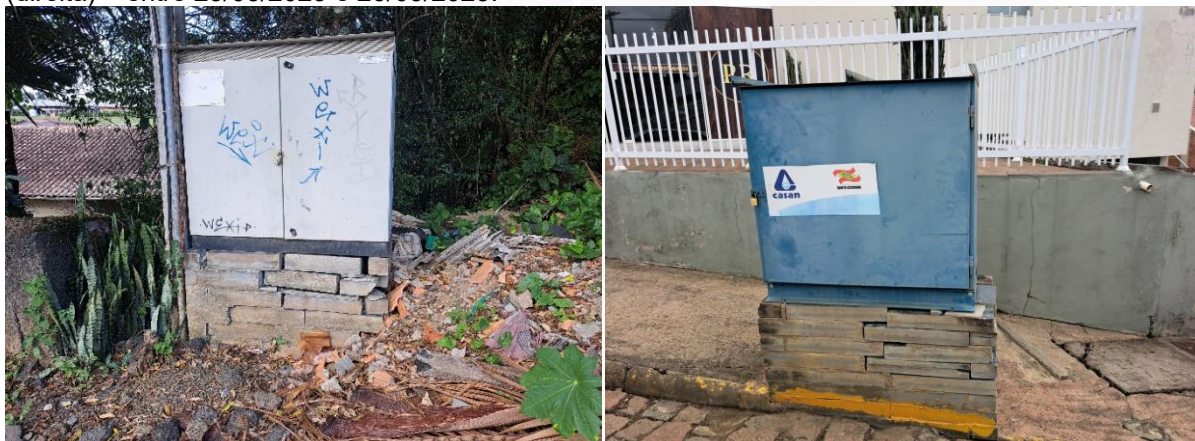
Figura 65: Problemas nas bases construídas com blocos de rocha - Booster 9 (esquerda) e booster 75 (direita) – entre 25/03/2025 e 26/03/2025.
