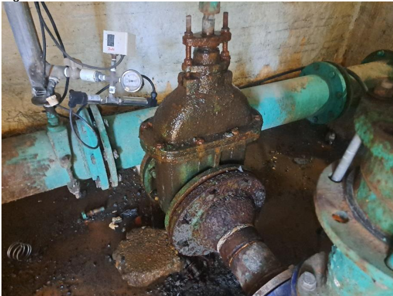
Figura 66: Vazamento em válvula do booster 14 – em 26/03/2025.
