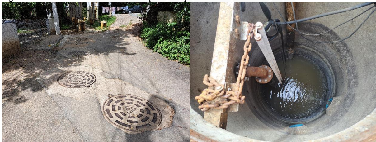
Figura 73: Elevatória EE-E3- 5 CV – Poço de sucção – 03/2025.
