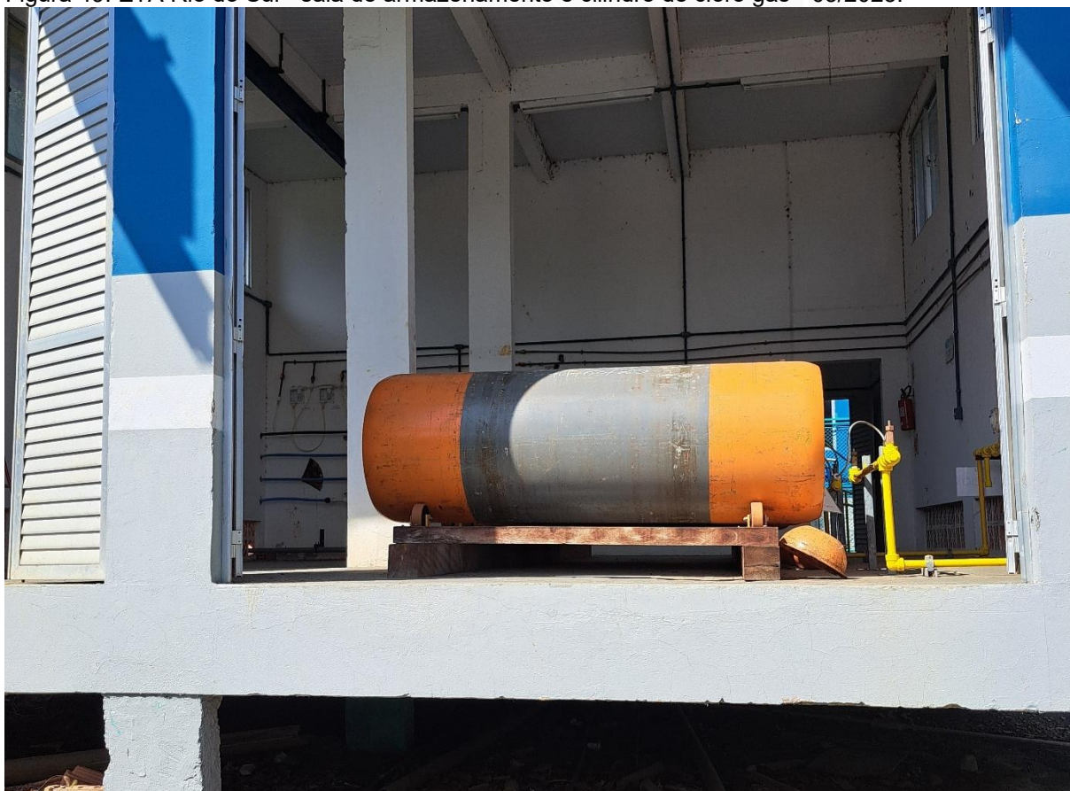
Figura 49: ETA Rio do Sul - sala de armazenamento e cilindro de cloro gás - 03/2025.
