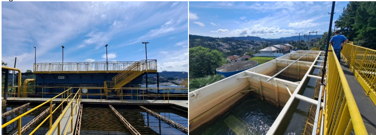
Figura 48: ETA Rio do Sul – filtros adicionais em módulo metálico – 03/2025.
