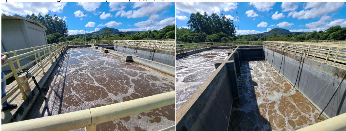
Figura 81: ETE Rio do Sul – tanque de aeração 01 em operação (esquerda) e tanque de aeração 02 operando com água da chuva (direita) - 03/2025.
