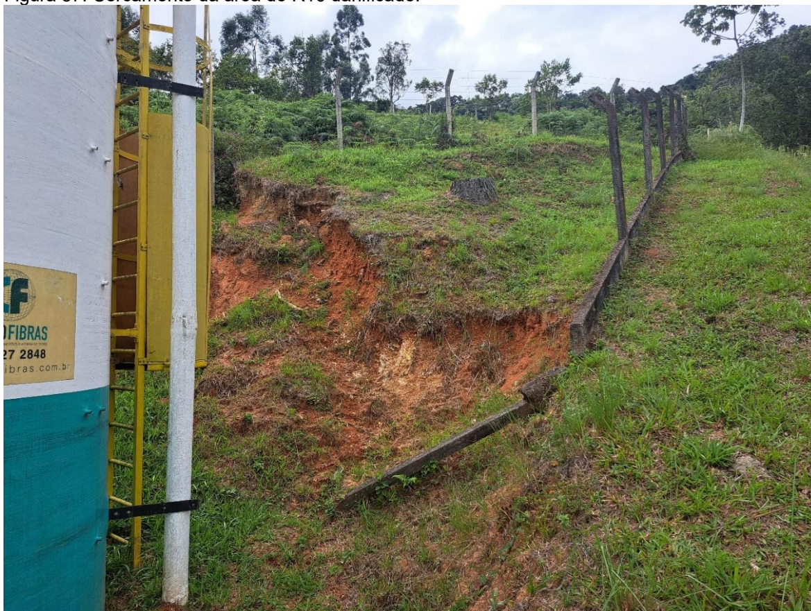
Figura 57: Cercamento da área do R16 danificado.
