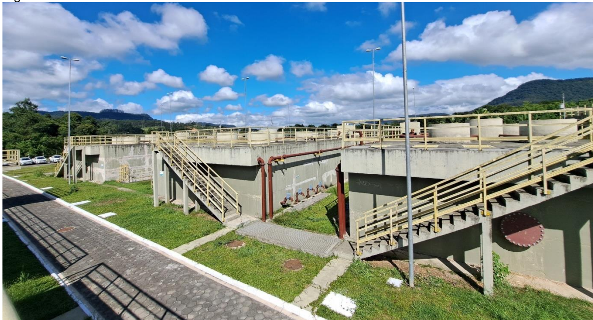
Figura 78: ETE Rio do Sul - Reatores UASB - 03/2025.
