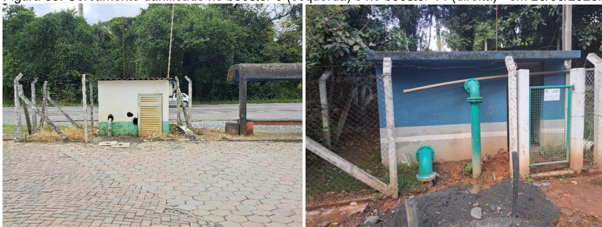
Figura 60: Cercamento danificado no booster 6 (esquerda) e no booster 14 (direita) - em 26/03/2025.
