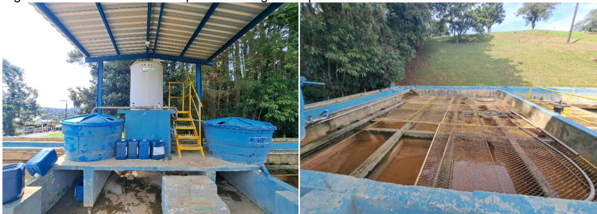
Figura 44: ETA Rio do Sul: tanques de dosagem de polímero e flocculadores – 03/2025.
