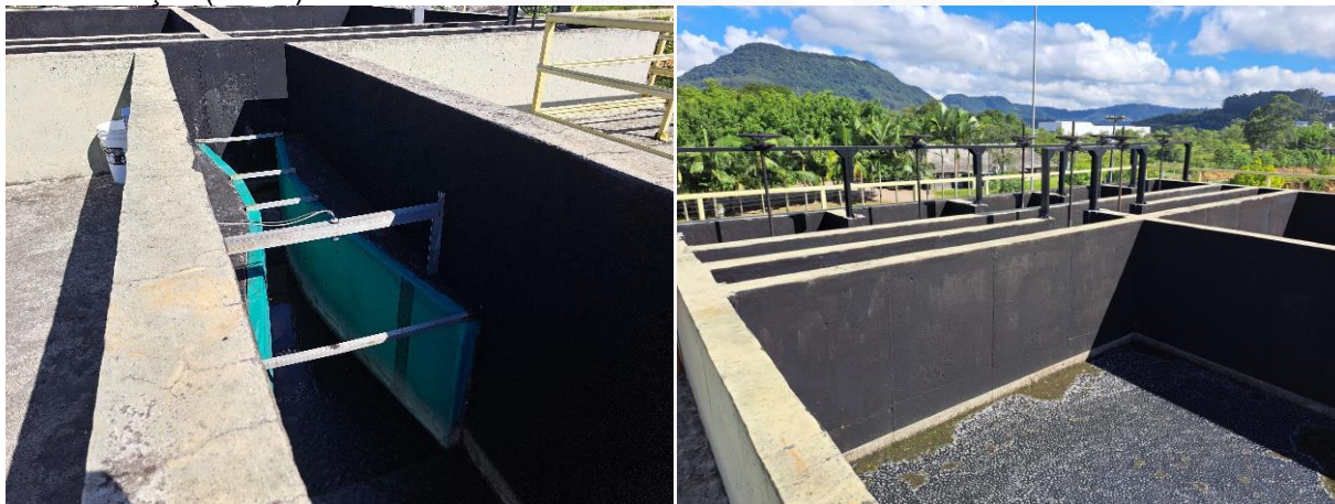
Figura 77: ETE Rio do Sul - Controle da vazão – Calha Parshall (esquerda) e caixa de gordura e canais de distribuição (direita).
