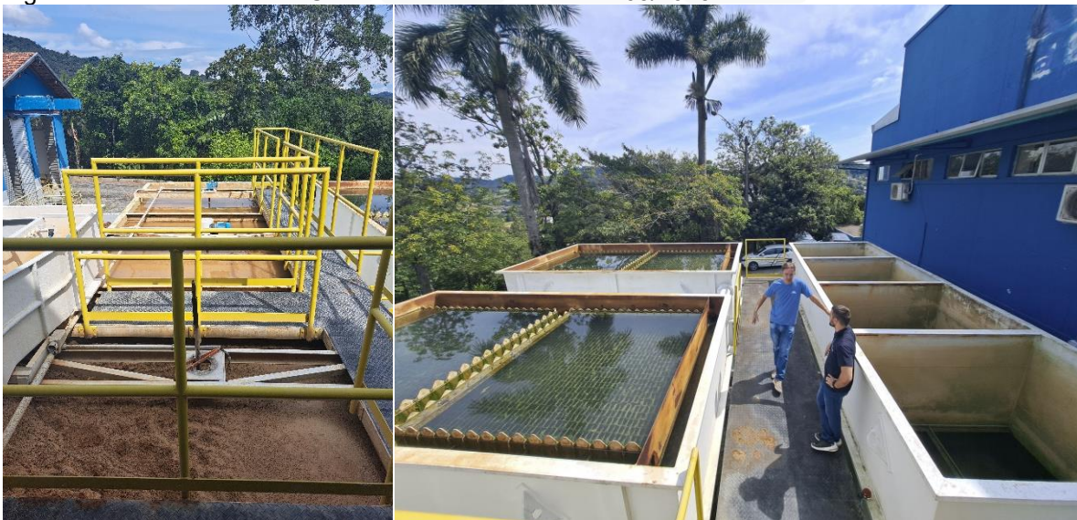
Figura 41: ETA Rio do Sul - Unidades da ETA metálica – 03/2025.
