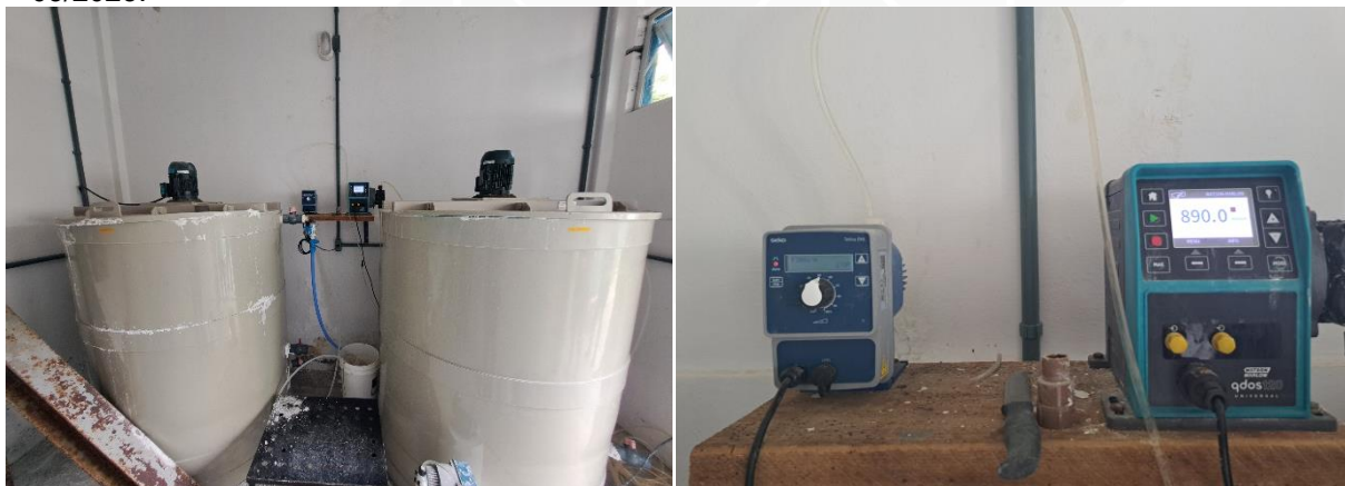
Figura 43: ETA – correção de pH - tanques de preparo e bombas dosadoras – ETA de concreto armado – 03/2025.
