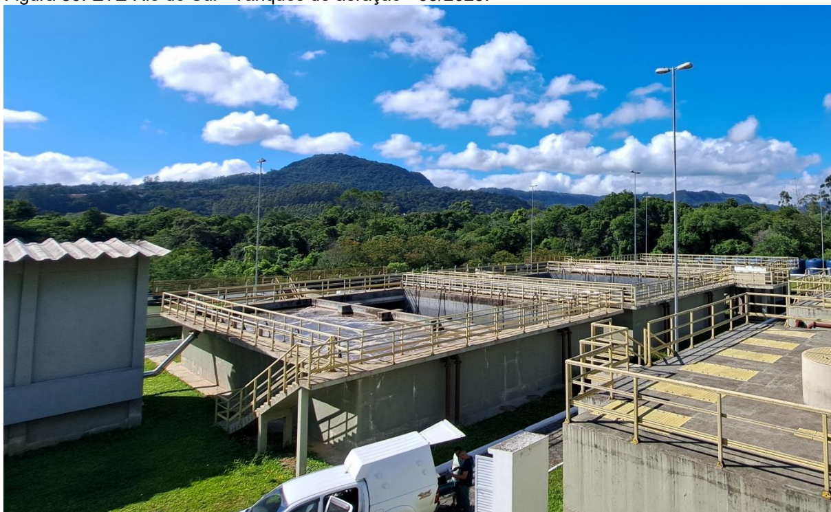
Figura 80: ETE Rio do Sul - Tanques de aeração - 03/2025.
