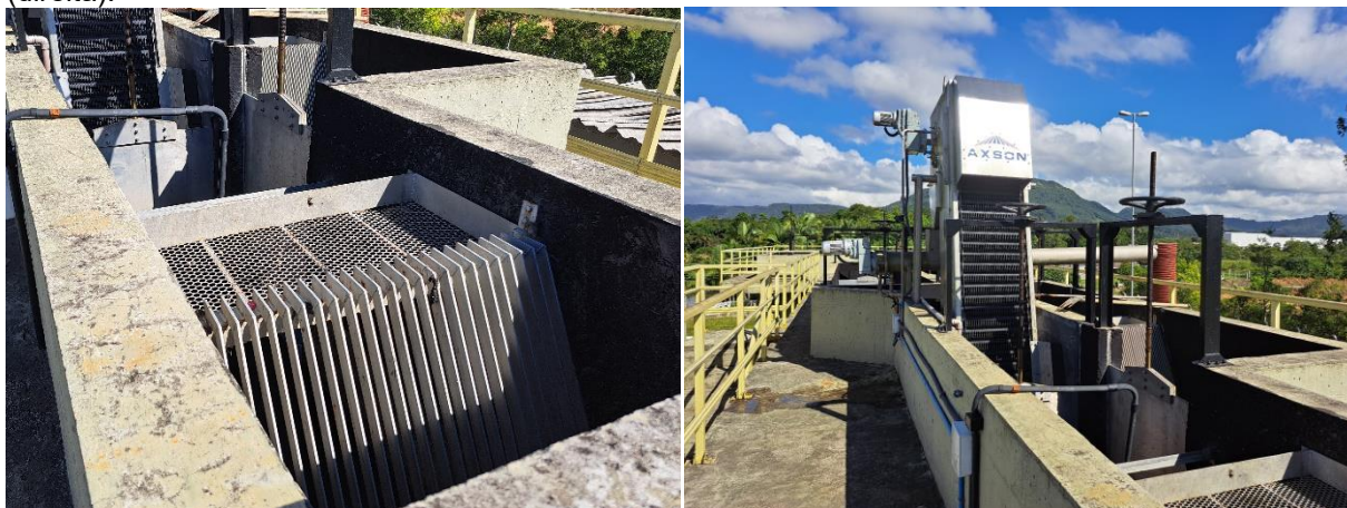
Figura 76: ETE Rio do Sul - Gradeamento manual grosseiro (esquerda) e peneiramento automático (direita).
