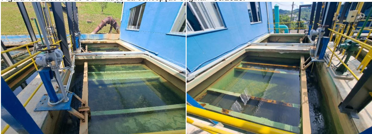
Figura 47: ETA Rio do Sul - filtros da concepção original - 03/2025.
