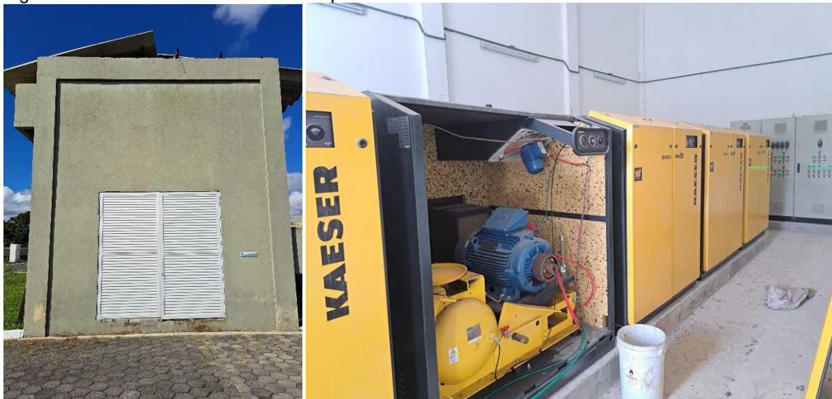
Figura 82: ETE Rio do Sul – sala dos sopradores - 03/2025.
