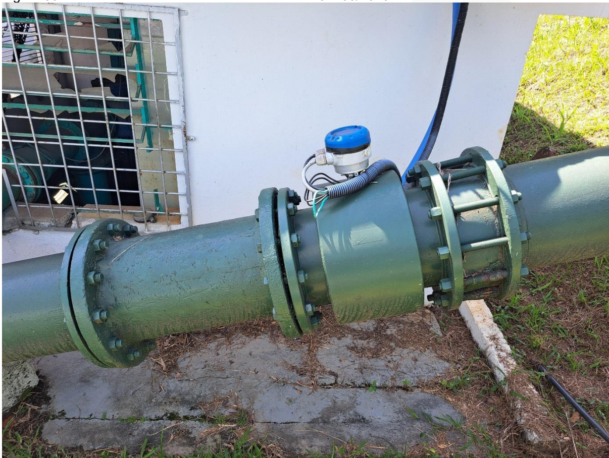
Figura 50: ETA Rio do Sul - macromedidor da ERAT 3 – 03/2025.
