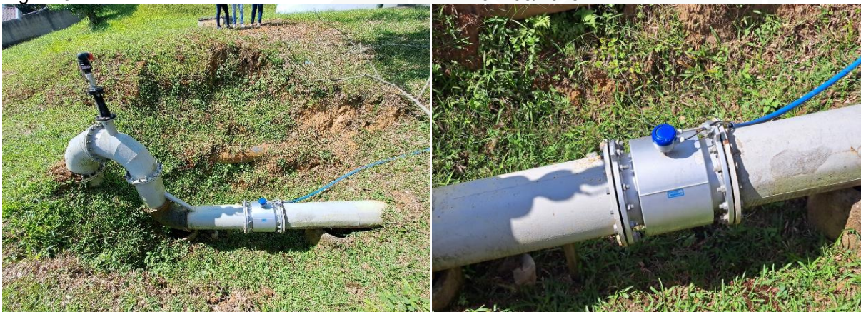
Figura 51: ETA Rio do Sul - macromedidor da Adutora R0 – 03/2025.
