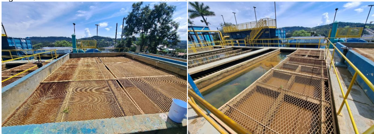
Figura 45: ETA Rio do Sul - flocculadores – 03/2025.
